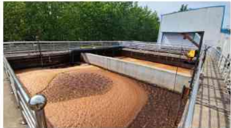
二级反硝化池、二级硝化池
