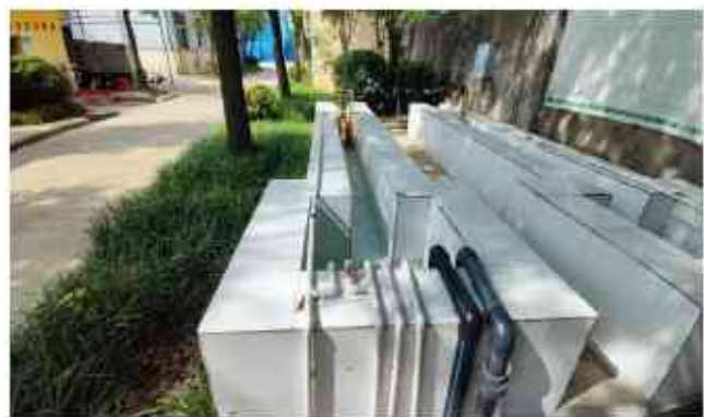
污水排放口（本项目）
