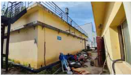
二级反硝化池、二级硝化池、沉淀池
