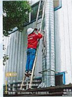
DA001 挤出废气排气筒
