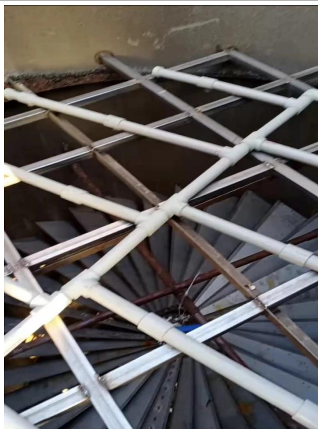
生产废气喷淋塔（内部）
