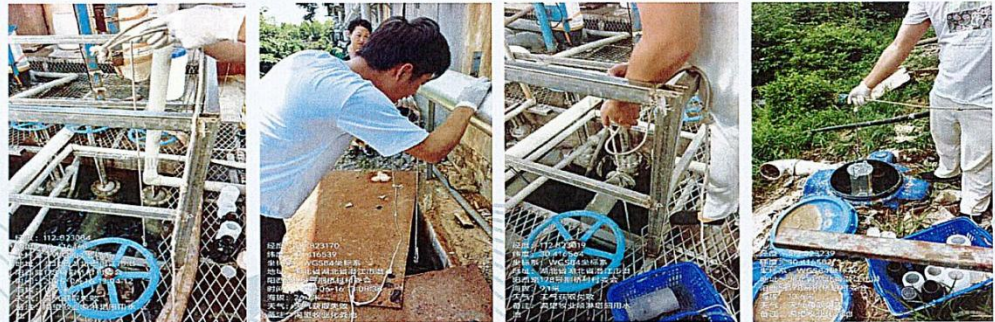
16 日 S1 喷淋塔废回用水池
