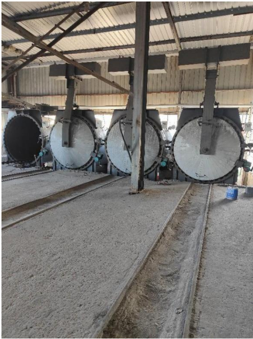
蒸养釜下方为雨水收集池
