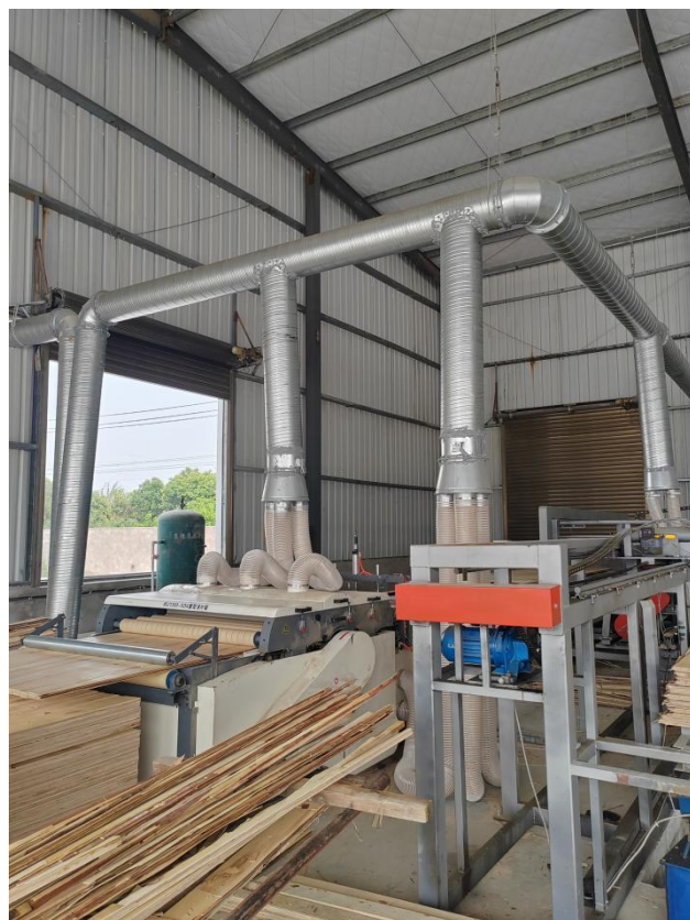
木工工序集气装置
