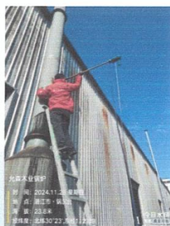
生物质锅炉废气排气筒 DA003
