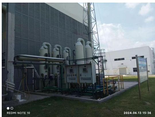
碱液喷淋装置及排气筒
