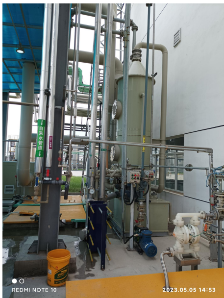
二级水喷淋装置
