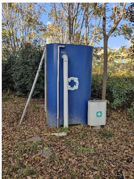
污水处理装置
