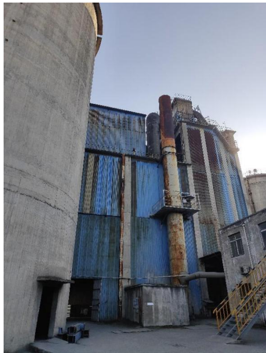
粉磨布袋除尘器及排气筒
