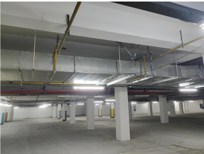
车库换气系统
