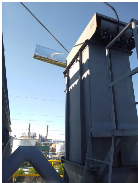
渣仓布袋除尘器
