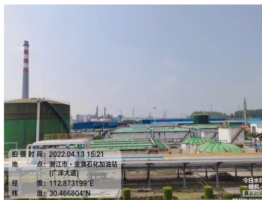
厂区污水处理站
