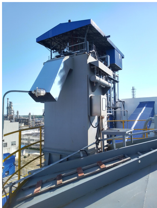
灰仓布袋除尘器
