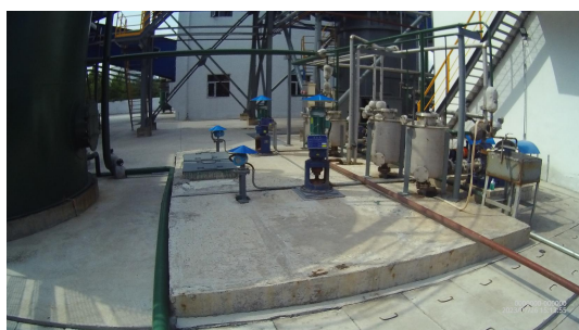
热能车间废水收集池
