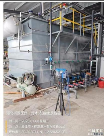
○6污水处理站UASB反应器旁
