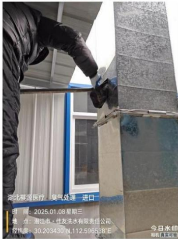
◎1臭气处理设施进口
